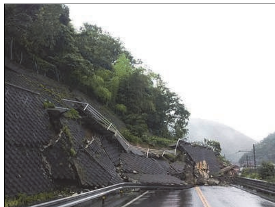
国道 27 号の法面崩壊（舞鶴市真倉地区）
