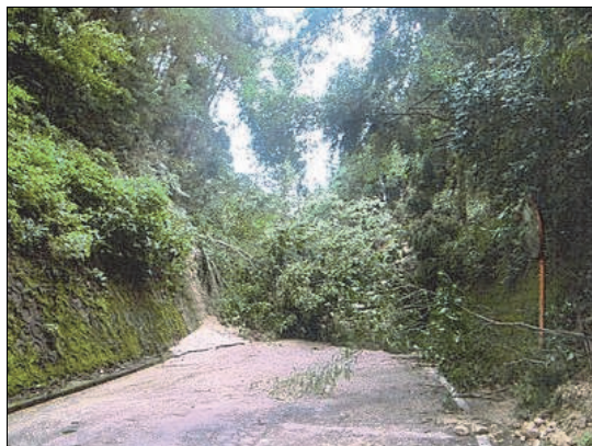
県道富士三瀬線の法面崩壊
