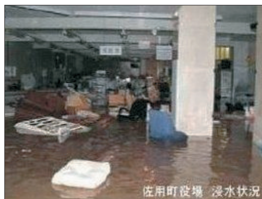
佐用町役場の浸水被害
