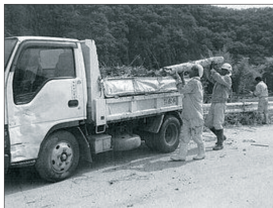
道路上の流木撤去
