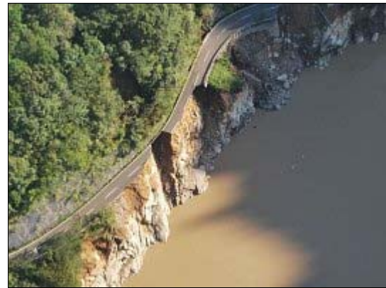
国道 168 号の崩壊状況
