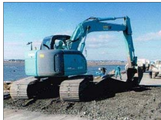
津波で分断された県道の緊急復旧
