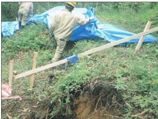
国道 9 号水原地区の法面崩落現場
