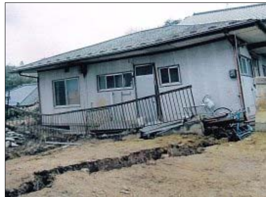
地割れによる庭の沈下
