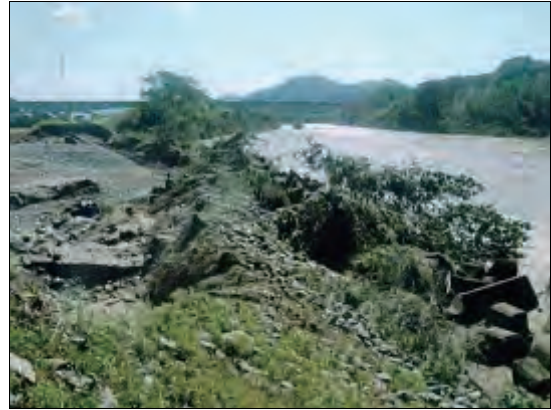
由良川堤防の損壊
