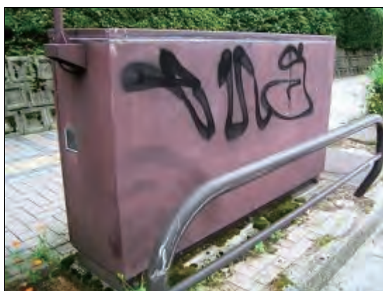
融雪装置制御盤への落書き
