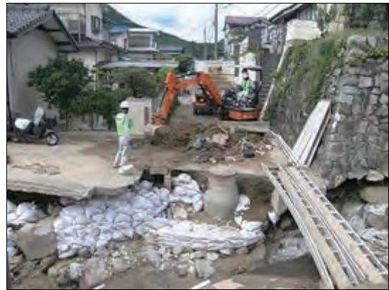
市道の崩落（復旧前）
