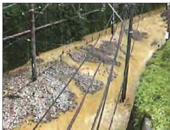
京阪電車軌道敷の土砂（提供：京阪電鉄）
