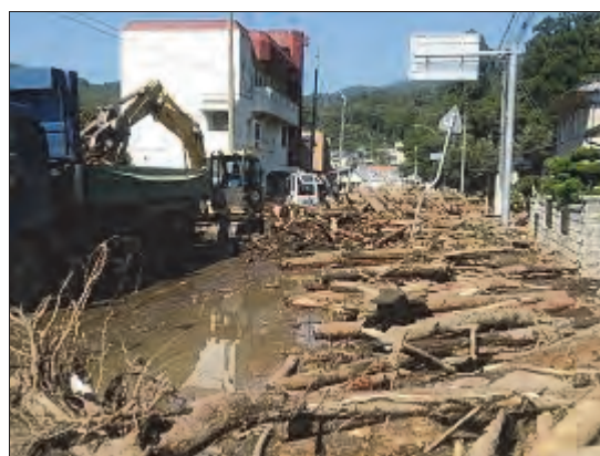
道路の泥上げ (普代小屋瀬線)
