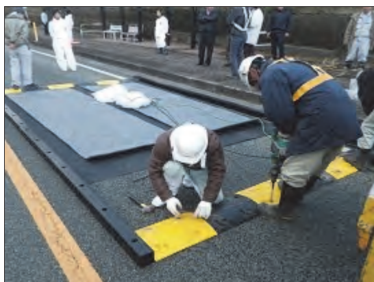
新型「マット併用型プール式消毒槽」設置
