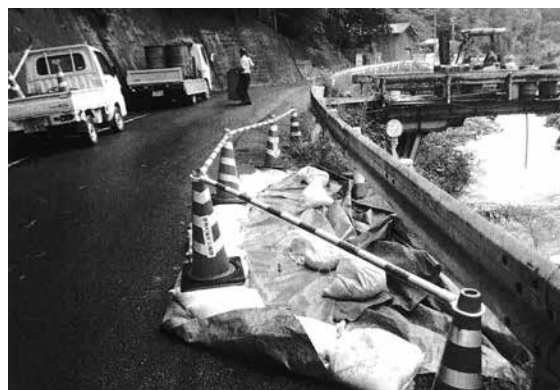
被災した現場の応急復旧状況
