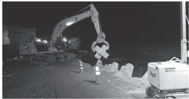
令和3年8月大雨 犀川での堤防復旧夜間作業 (長野県建設業協会)
