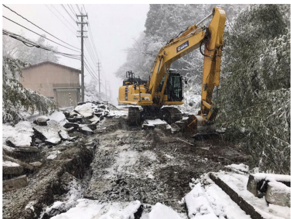
○鳳珠郡能登町宮犬地内（1月13日） 提供：加賀建設(株)
