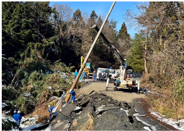
○鳳珠郡穴水町地内（1月14日） 提供：小川建設(株)
