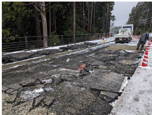
○輪島市門前町別所地内（1月23日） 提供：木野建設(株)
