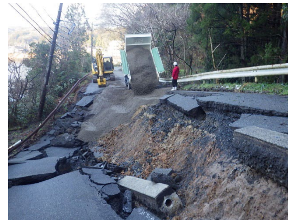
○鳳珠郡穴水町川尻地内（1月11日）
