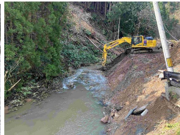
○輪島市別所谷町地内（3月29日） 提供：鈴木建設(株)
