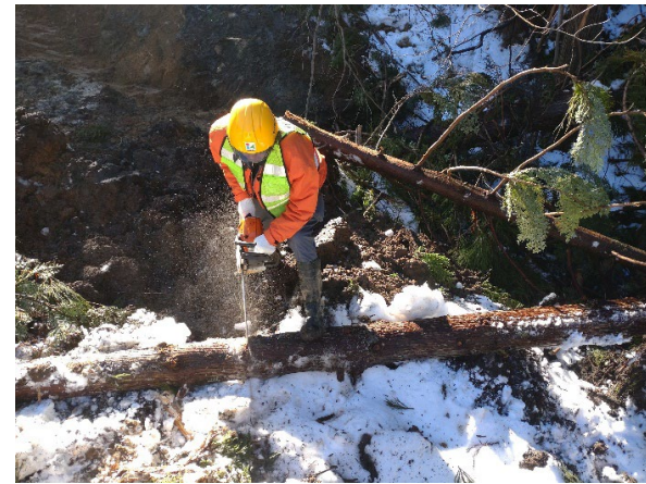
○輪島市門前町二又川地内（1月17日） 提供：北川建設(株)
