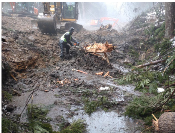
○輪島市門前町二又川地内（1月18日） 提供：北川建設(株)
