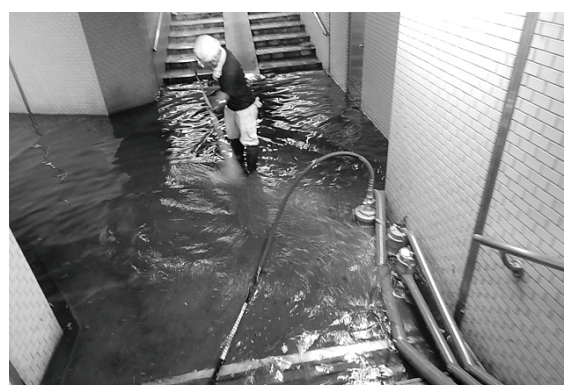
静岡県建設業協会による下水道冠水排水作業 (静岡県焼津市)
