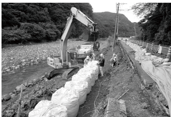
台風17号時における長崎県建設業協会による 道路災害防除対応（長崎県対馬市）
