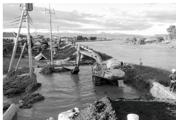
栃木県建設業協会による河川堤防緊急応急(栃木県佐野市)
