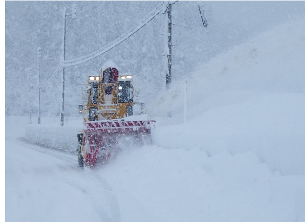
除雪作業 新潟県建設業協会 (上段)令和8年1月 津南町 国道353号線 (下段)令和8年1月 津南町 加用今新田津南線
